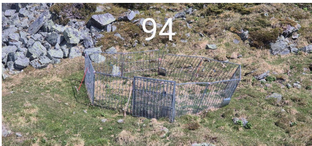
Bildetekst: Grindanlegg 94 i Aurland kommune i Nordfjella. Deler av ei grind er ødelagt og må skiftes for å unngå fare for skade på dyr og større skader på grindanlegget neste vinter. Observert ved tilsyn juni 2025. Bilde tatt av Runar Bjøberg.
