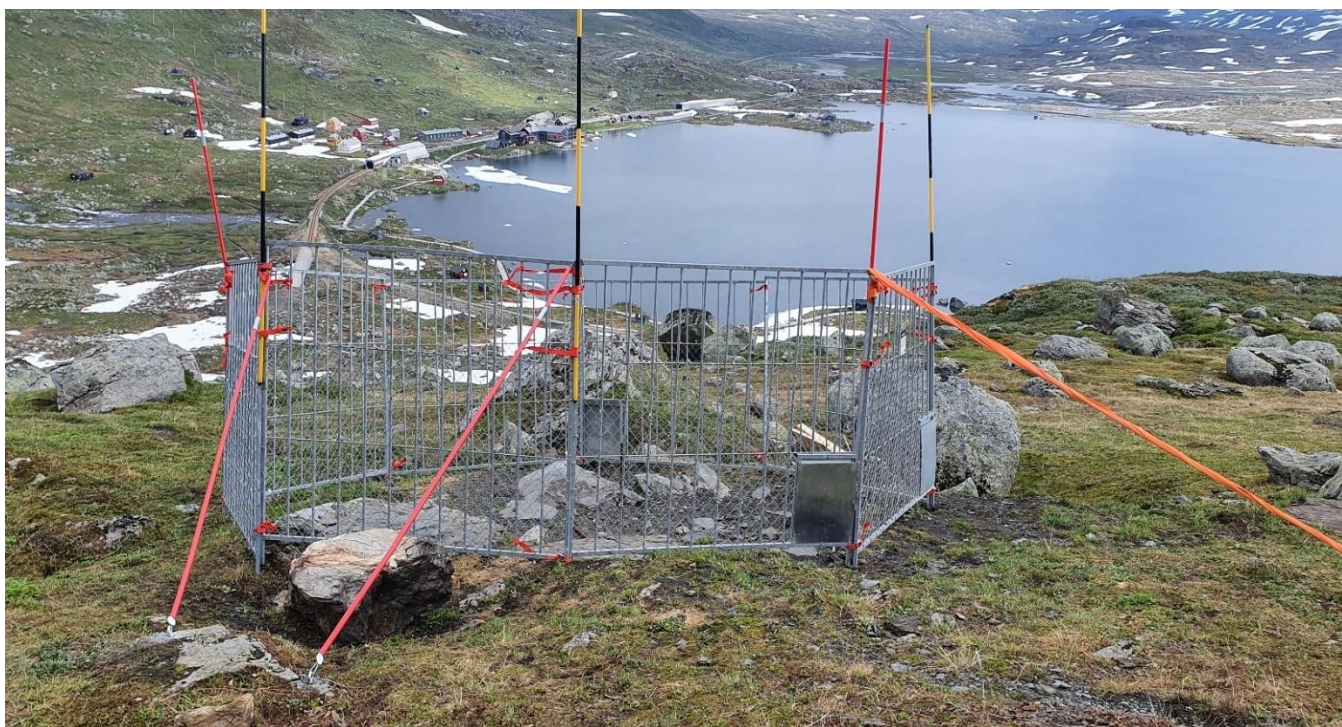
Bilde 34: Grindanlegg på Finse som var ødelagt av snøtyngde (se bilde 3) etter utskifting av grinder og ny montering. Grindanlegget er sikret med barduner av stålvaier og jekkestropper. Vaierbardunene er markert med plasthylser og reflekser for å ivareta sikkerheten. Dette grindanlegget står også i en bakke med mye skikjøring vinterstid. Det er derfor markert med brøytestikker på toppen av grindene. (Foto: Runar Bjøberg)
