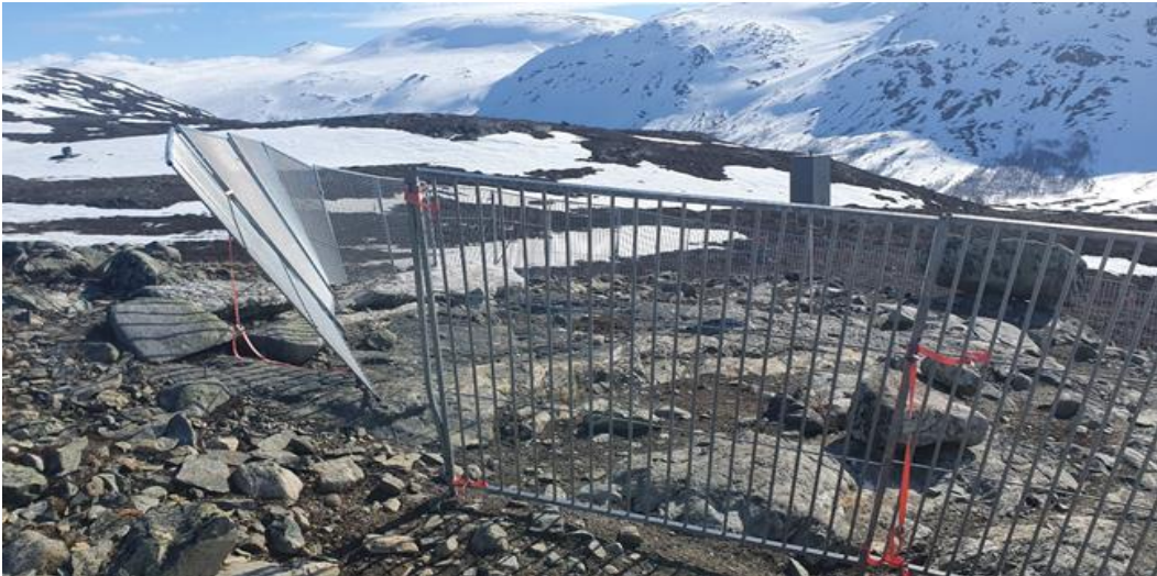
Bilde 1: Grindanlegg i Hemsedal 19.05.20. Ei grind er ødelagt i sveisene i hoveddramma. (Bilde: Runar Bjøberg)
