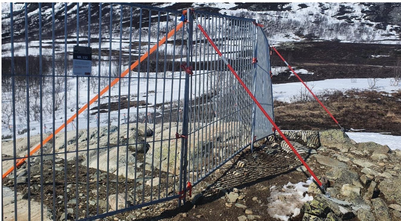
Bilde 33: Stort grindanlegg i krevende terreng i Hemsedal. Grindanlegget er reparert våren 2020 etter skader. På store grindanlegg har bardunering både utvendig og innvendig vist seg nødvendig for å stabilisere grindene. (Foto: Runar Bjøberg)
